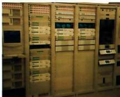
Blik op controlemonitor in Multiplexcenter van Digitenne.
